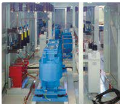
Instalação de tratamento de água
